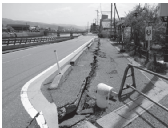
写真1 液状化による天端の変状
