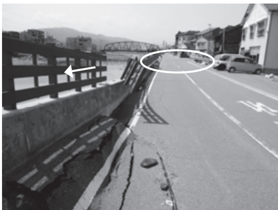
写真3 樋門箇所の路面状況
