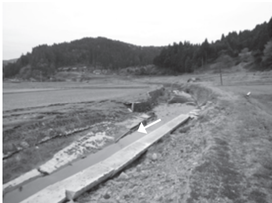
写真7 広範囲に及ぶ護岸の破損
