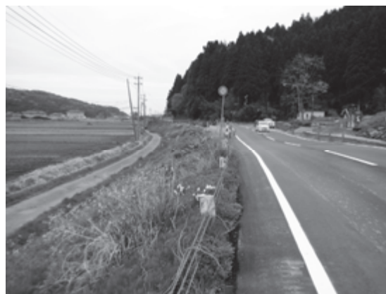
写真10 側方流動と路面のうねり
