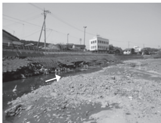
写真2 護岸の被災状況
