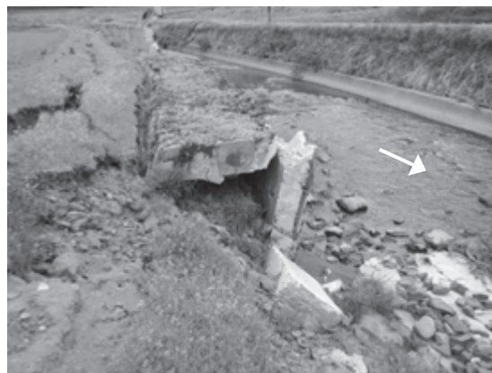
写真6 中間部で折れ曲がった護岸
