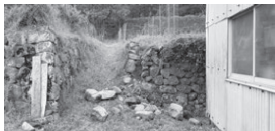
写真-1 石積倒壊状況
