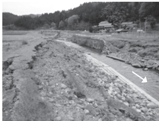
写真5 前方に倒れた護岸
