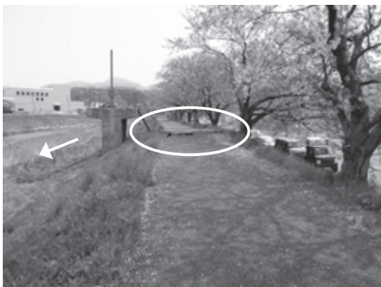
写真4 樋門箇所の抜け上がり
